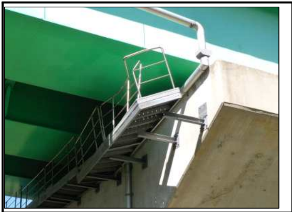
사진번호 54 교각 P4 점검통로 변형(2020.12) 외관망도 -
