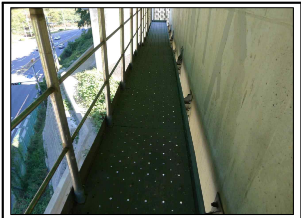
사진번호 52 교대 A1 점검통로 설치현황 외관망도 -
