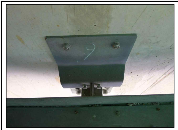
사진번호 55 교대 A1 브라켓 보강현황 외관망도 -
