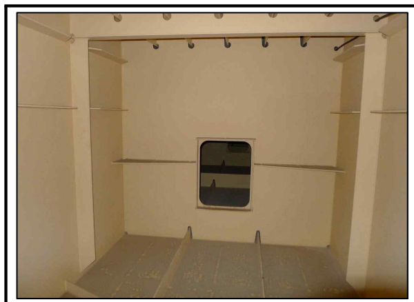
사진번호 34 거더내부 S1 G1 외관망도 - 다이어프레임 상태양호
