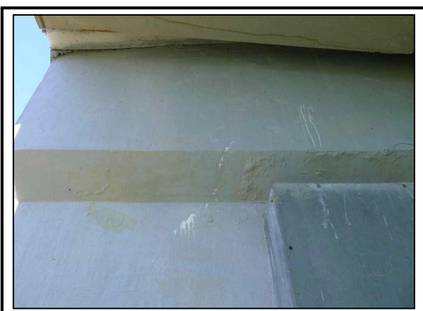
사진번호 41 교대 A2 흥벽 백태 외관망도 50-1
