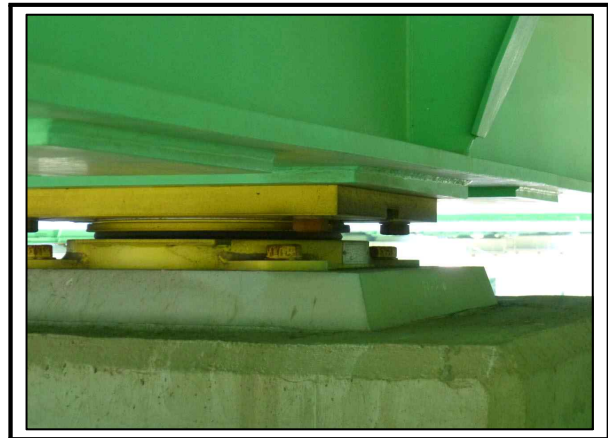
사진번호 38 교량받침 P4 Br2 볼트 외관망도 54-3 부식
